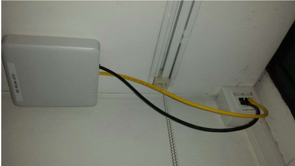
Abbildung 22: Access-Point mit zwei Kommunikationsanschlüssen
